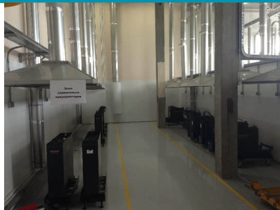
Зона зарядки аккумуляторов
