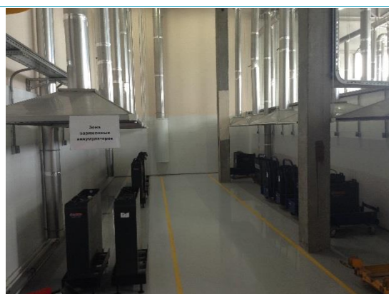
Зона зарядки аккумуляторов
