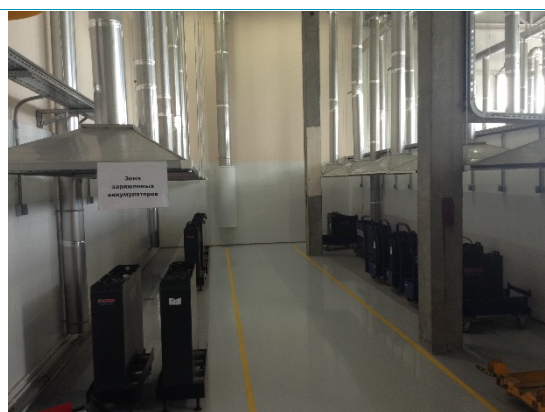
Зона зарядки аккумуляторов
